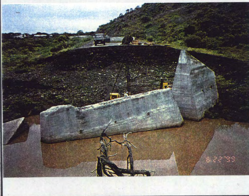
流失した橋台
