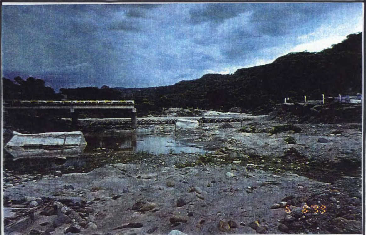
3 径間のうちの 1 径間及び橋台背面道路部流失
