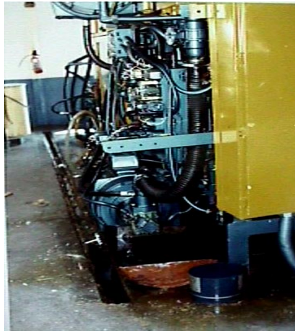
Fugas de aceite en máquinas
