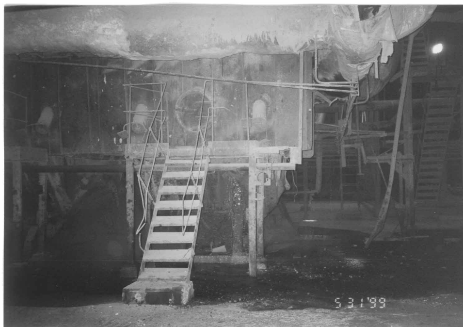
ボイラー底部
