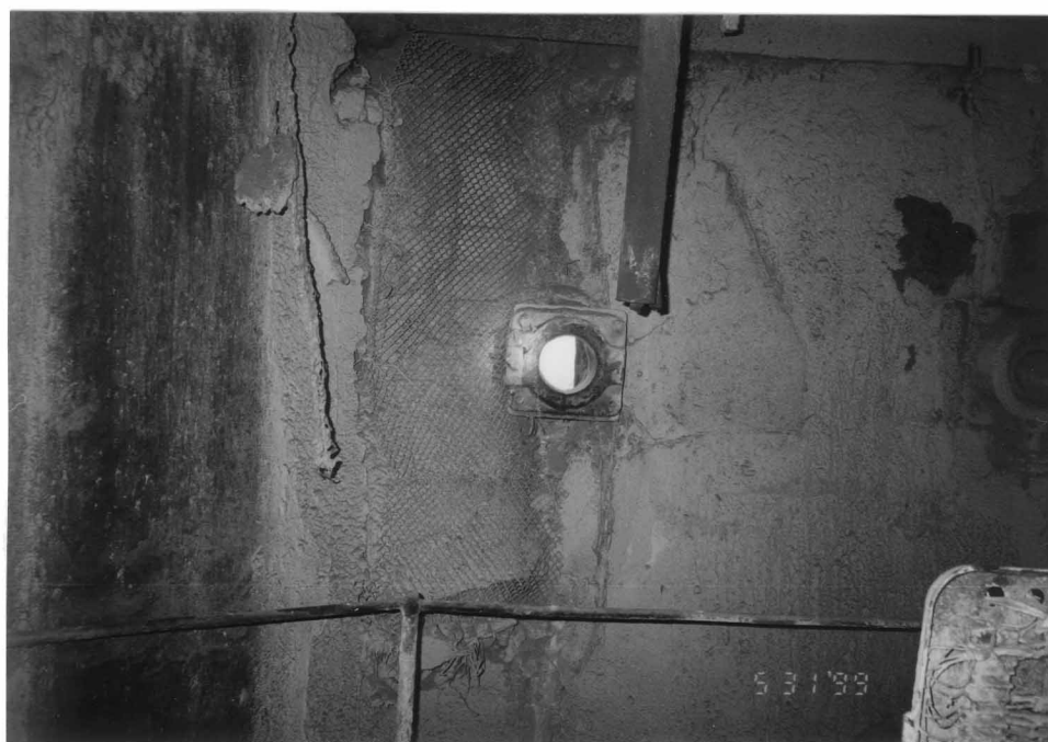
ボイラー側面
