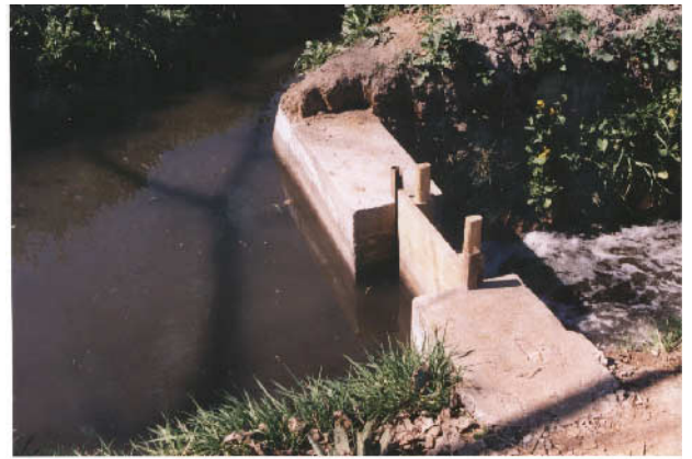
Estado de la contaminación del agua en la parte final del Canal Mallarauco
