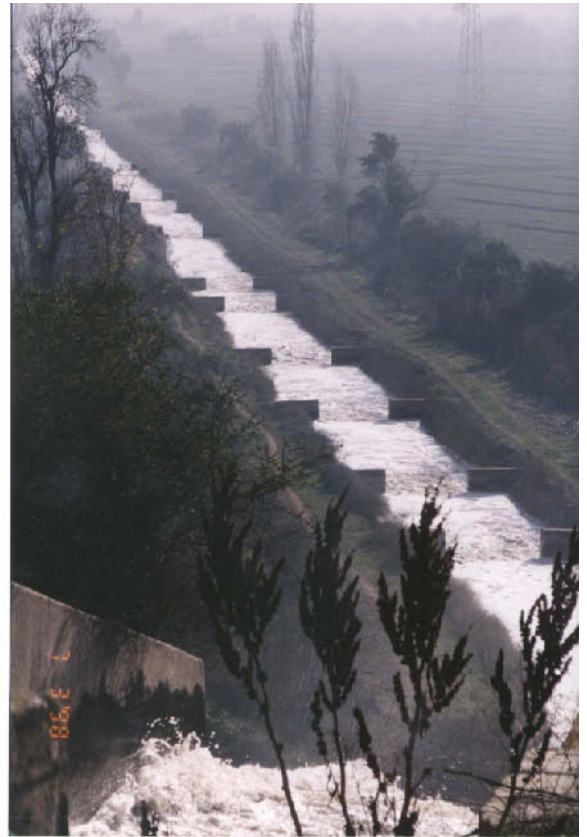
Disipador de energía en aguas medias del Canal Mercedes
