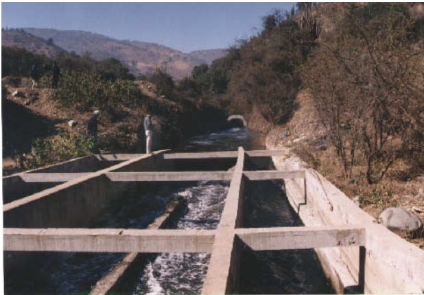
Mallarauco水路のトンネル出口後の分水施設
