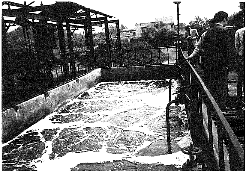
タイグエン製鉄 コークス工場の 廃水処理施設
