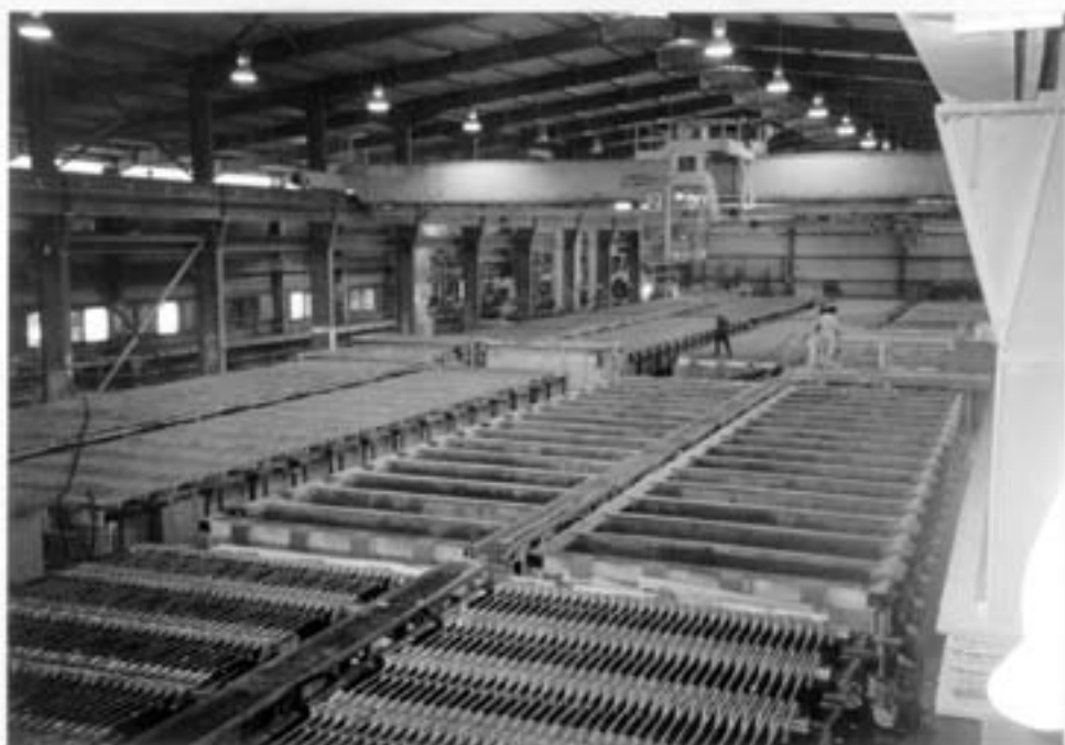
電解工場内部
