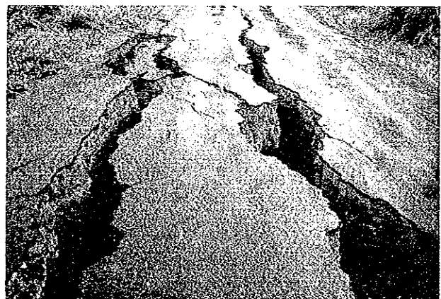
写真5.18 舗装面の亀裂
