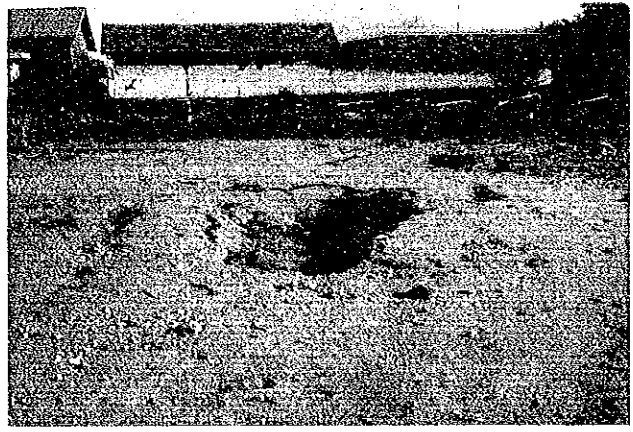
写真5.31 地盤の液状化による舗装面の亀裂と沈下
