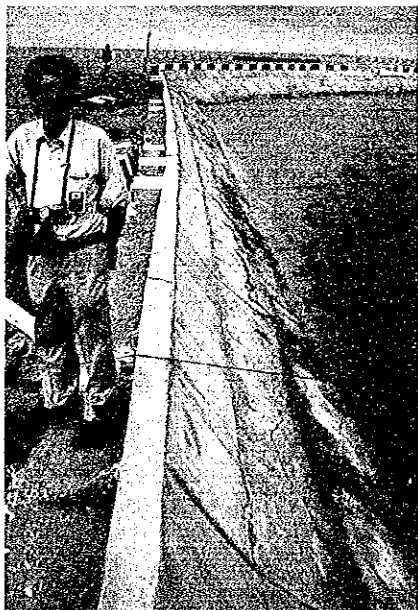
写真5.29 新しい港の擁壁に生じた亀裂
