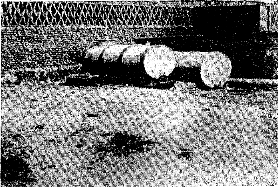
図IV-2-1-8 塩酸タンクの屋外設置状況
