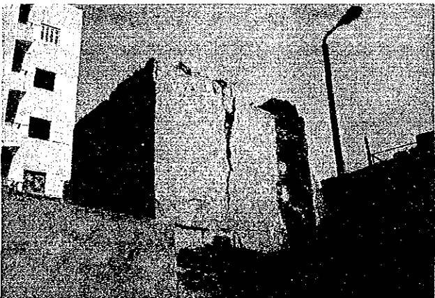
写真3.11.5 無筋組積造(両外方向に壁が崩れ落ちている)
