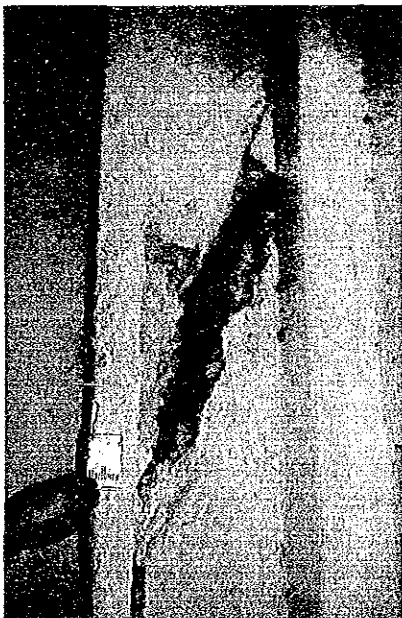
写真3.11.36 同上 柱のせん断破壊
