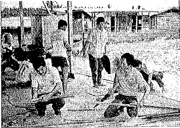
村人との共同作業による施設建設（土木施工）：サリマンド村
