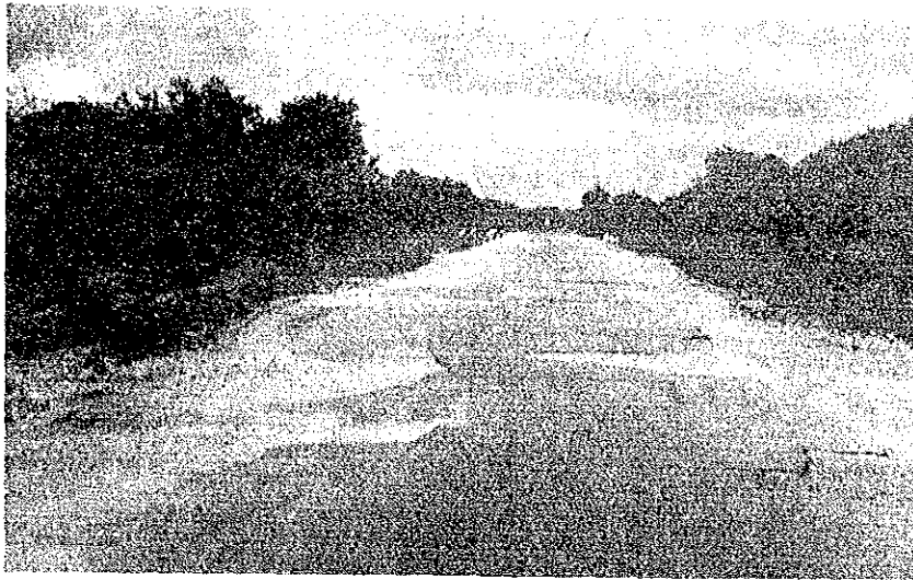
舗装道路も大雨の後はこのような状態に（タンザニア）
