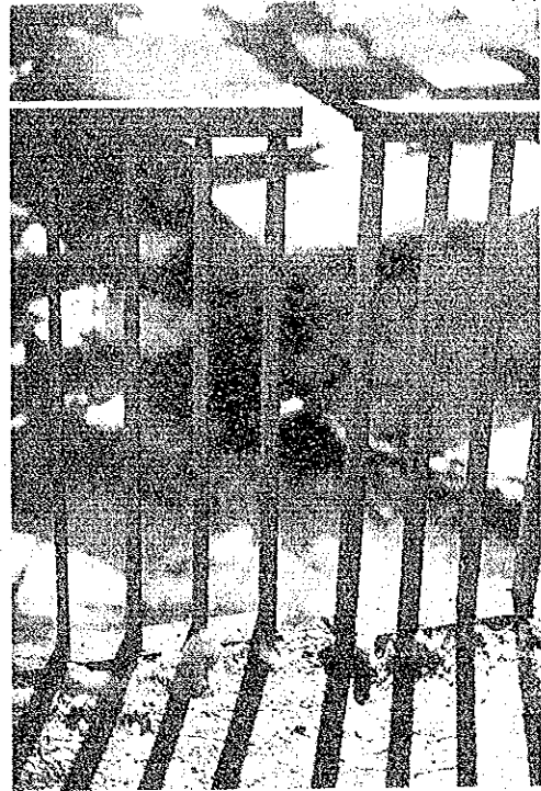
(b) 高欄の引き移り 桁端では特に継手は設けていないようで、舗装は連続して打たれている。高欄が約10cm引き抜けており、桁の残留移動があるためと考えられる。
