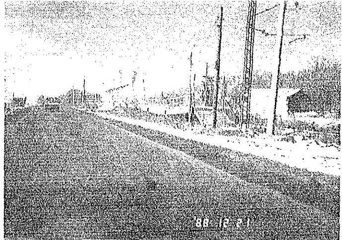
写真6.1.26 スピタク西方約10kmの小さな村落の鉄道駅。プレキャスト造のプラットホームの沈下。
