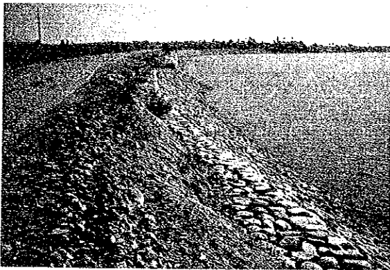
アグノ川 San Roque intake から下流約10 km 右岸 1886年に流失後築堤
