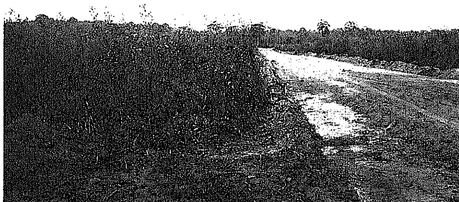
Base des routes d'agriculture (on va faire remblai dessus et revêtir de latérite) et terrain prévu pour le Centre (à gauche)
