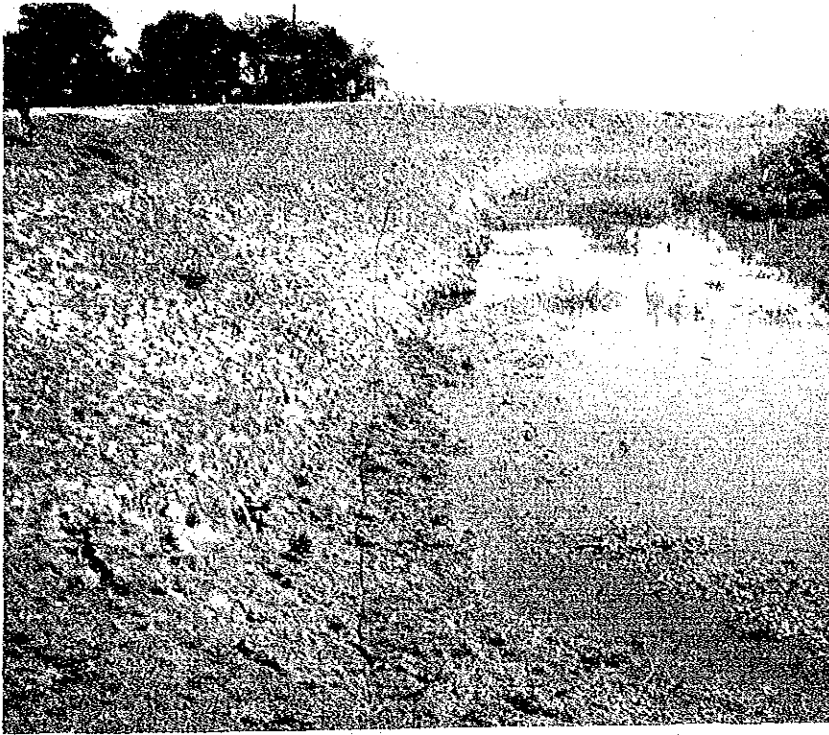
輪中堤防に接近して、堤体を洗掘するTatkir川 (CS-0.40km)
