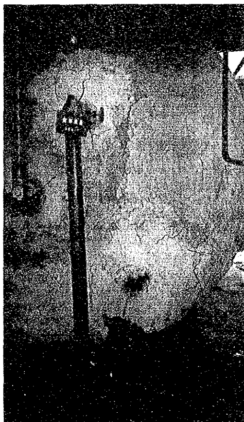
写真 2.2.3-4 精VCM貯槽液面計
