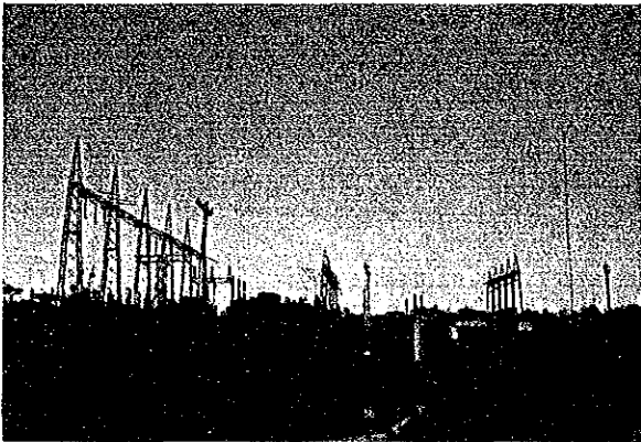
⑧ トリニダッド変電所 エンカルナシオンへ28 Km
