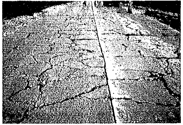
Malicboy 付近の峠の区間の舗装の破壊状況
