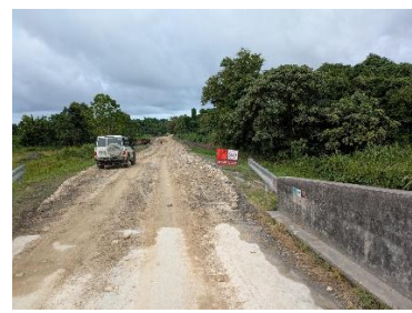
橋梁前後の舗装破損 対象橋梁：10 橋以上
