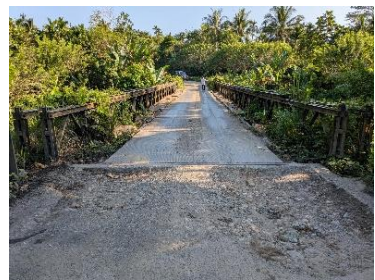
歩道が破損したベイリー橋
