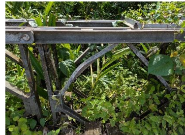
部材の損傷（ねじれ）
