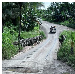
ベイリー橋（本線） 荷重の問題により横にBPが建設されている 緊急度（中）
