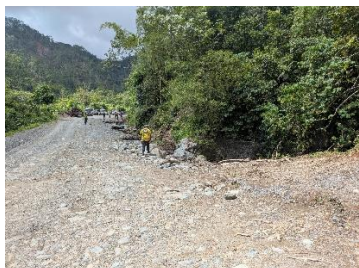
道路上への土砂流出
