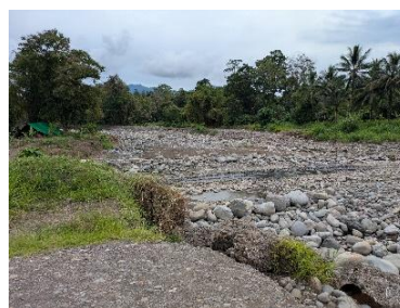
橋梁名：Aita Br. 新たな川の出現による既存道路 の流出（小規模カルバート区間）
