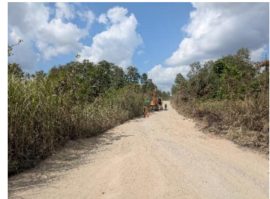
冠水区間（維持補修状況）
