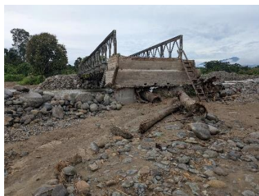
橋梁名：Ramason Br. アプローチ区間の流出 ベイリー橋の破損
