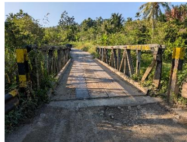
部材の変形したベイリー橋
