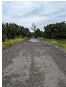
ガードレールの破損／消失 対象橋梁：3 橋
