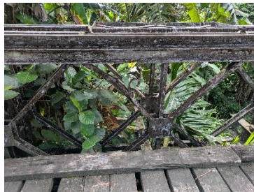
部材の破損（破断）
