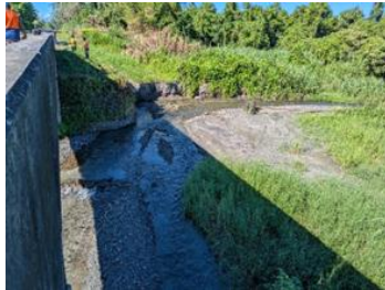
河川の斜面崩壊 橋梁名 Creepers Br.
