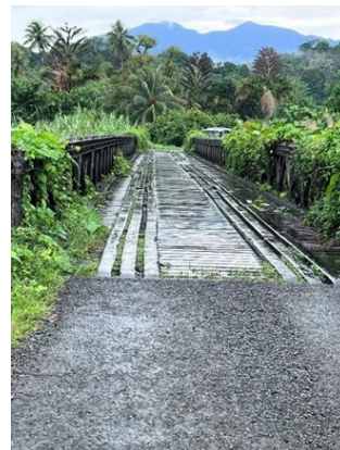
劣化が進行している Siang Bridge
