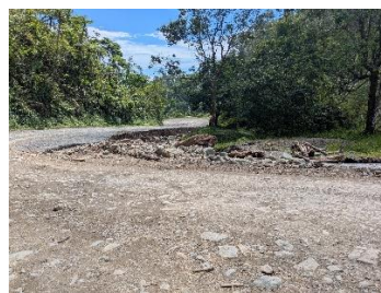
道路路肩部分の崩壊
