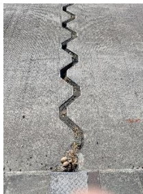
橋梁伸縮装置の経年劣化 対象橋梁：全橋
