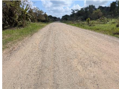
ほぼ消失した舗装
