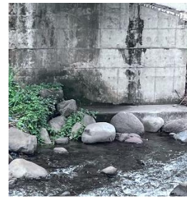
橋台／橋脚部での洗堀 橋梁名 Kaskrus Br.他 3 橋
