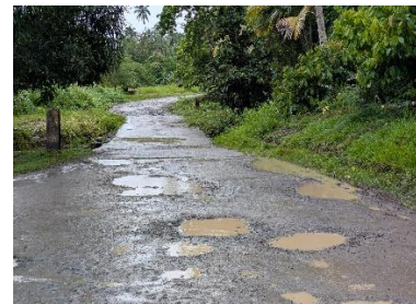
雨上がりの未舗装区間
