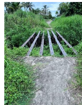
旧橋の老朽化
