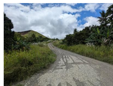
舗装状態が悪い区間
