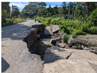
大雨による道路崩壊
