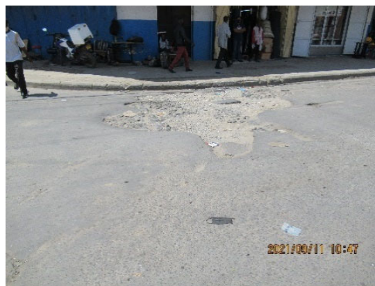
既存道路の舗装状態が悪く、 車両の通行に支障をきたしている
