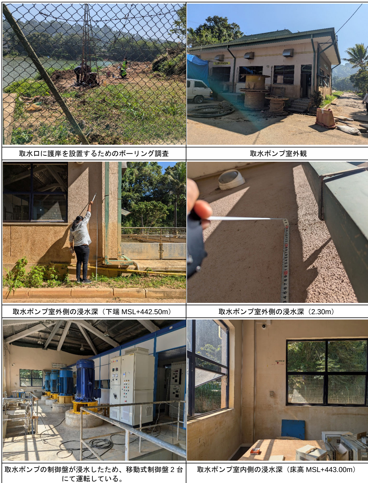
図 3.3.39 GKWTP 取水ポンプ場の被害状況 (2/4)
