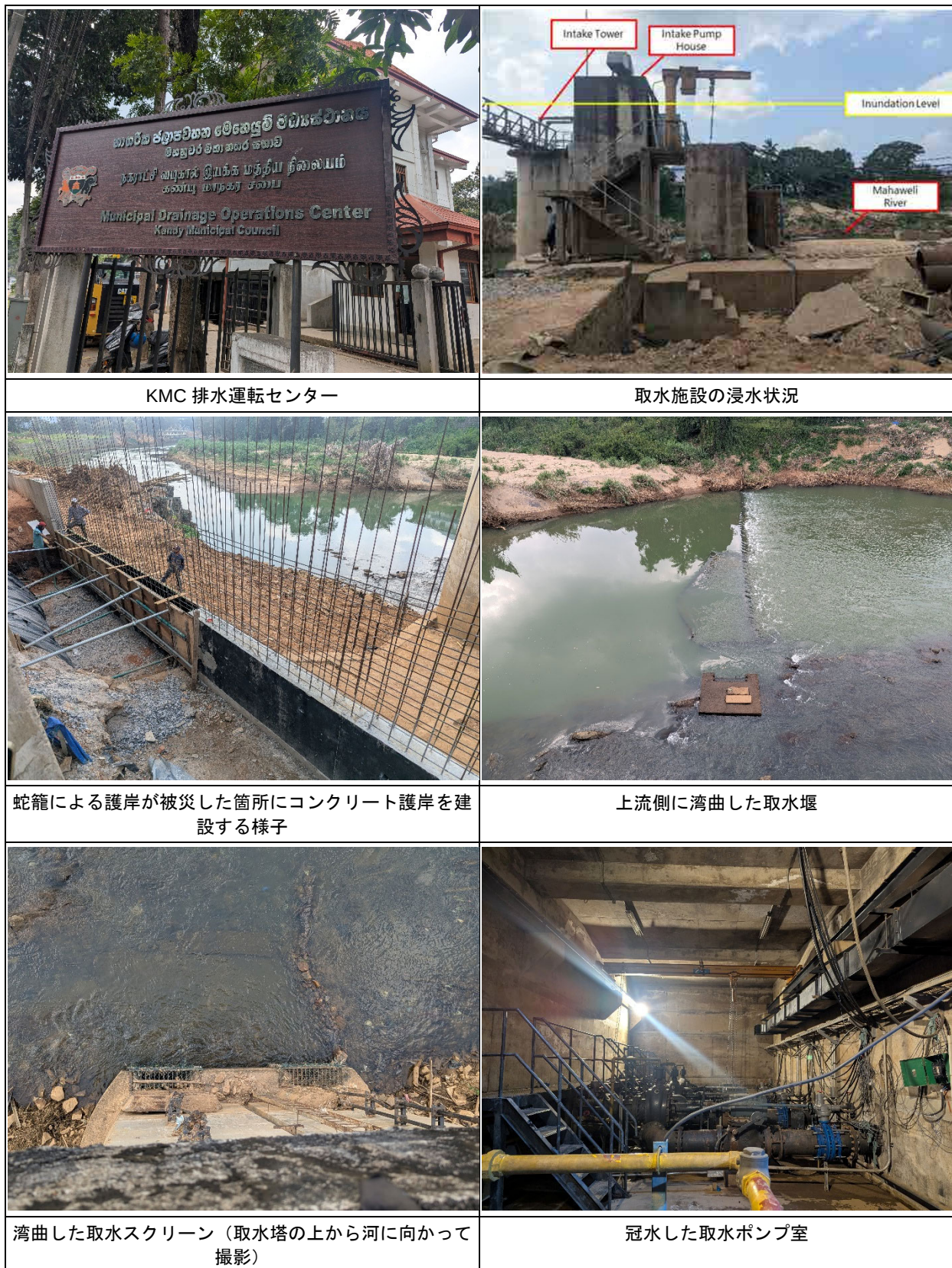
図 3.3.41 Gatambe 取水ポンプ場の被害状況 (2/3)
