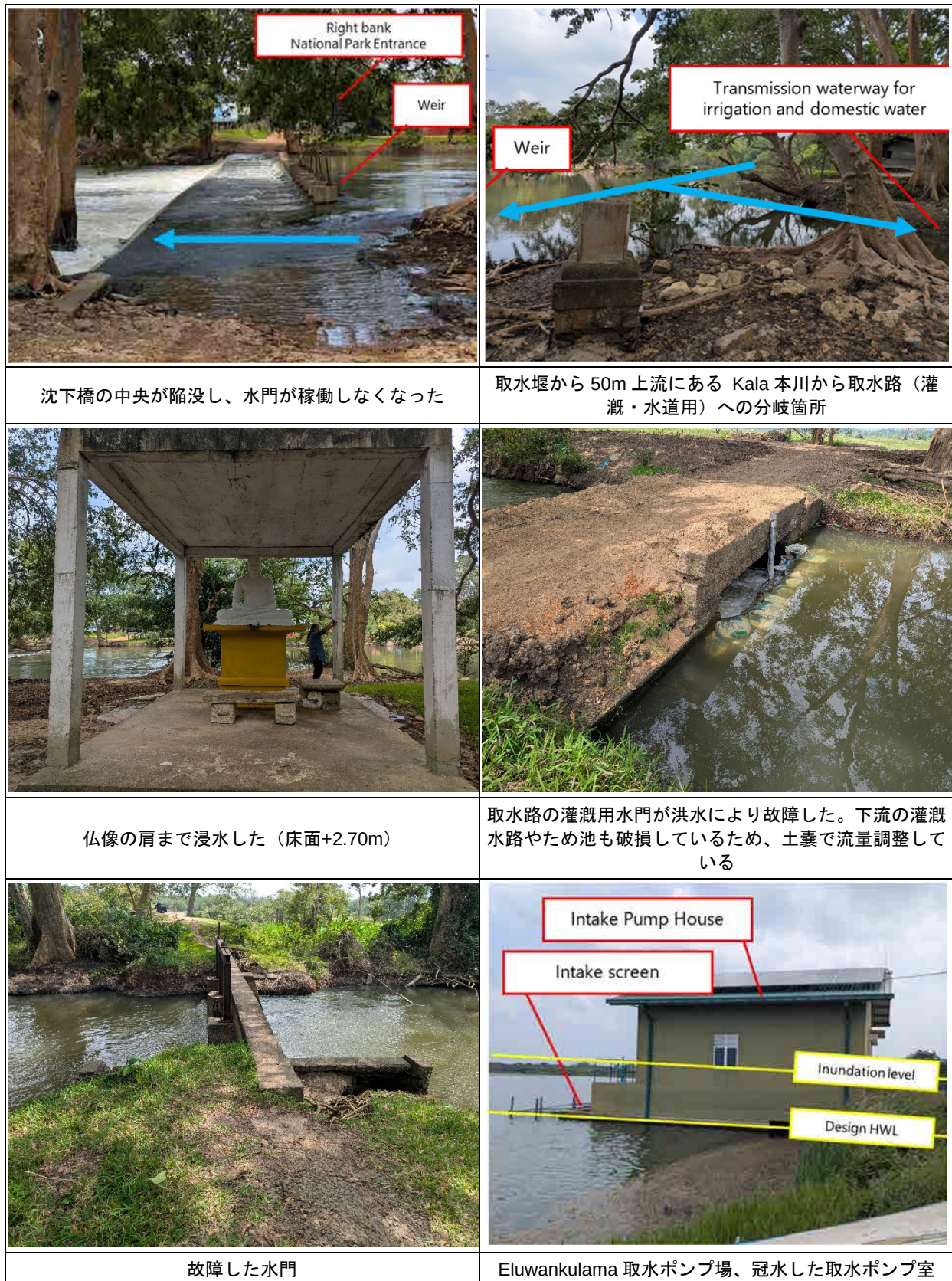
図 3.3.42 Eluwankulama 取水ポンプ場の被害状況（2/3）
