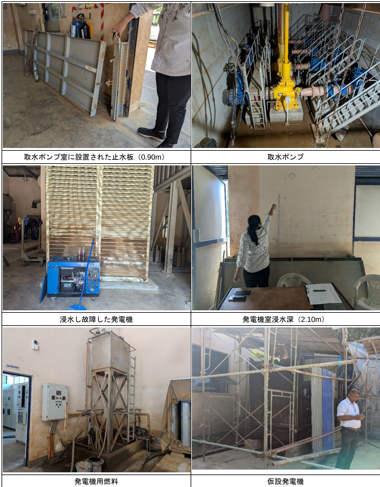
図 3.3.39 GKWTP 取水ポンプ場の被害状況（3/4）
