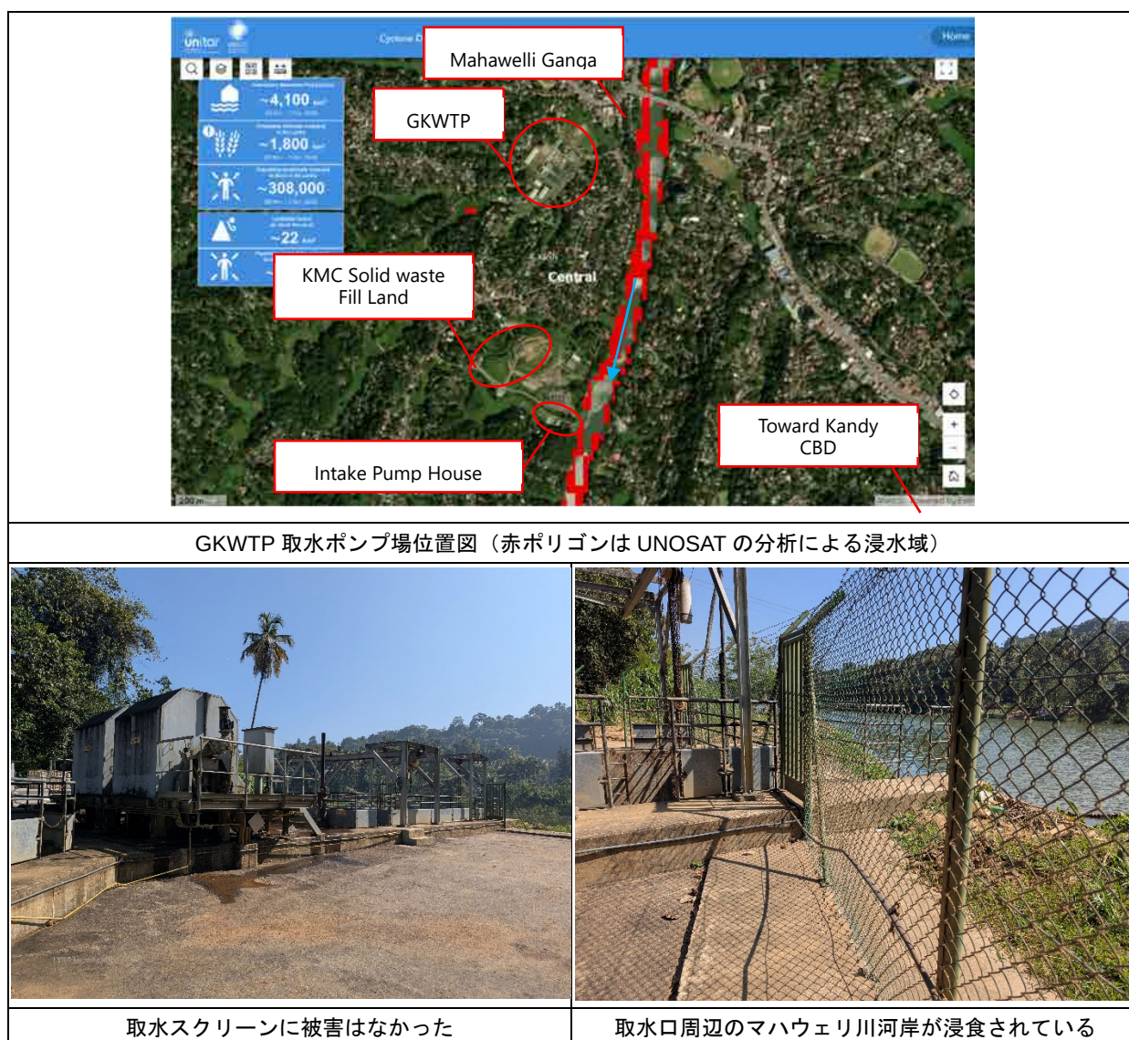
図 3.3.39 GKWTP 取水ポンプ場の被害状況（1/4）
