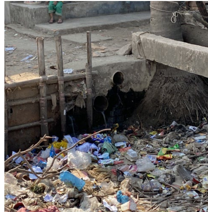
写真 3.1.1 既存水路への汚水放流
