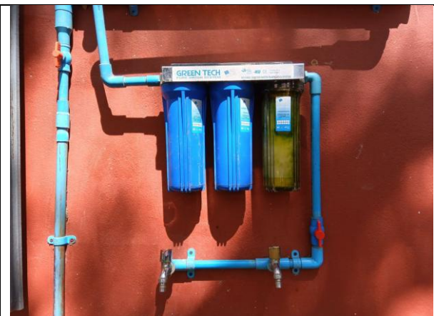
地下水のろ過機器：フィルターの交換は1カ月に1回行っている。
