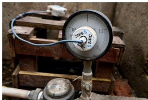
IoT 化圧力計センサユニットを取付けた公共水栓 (Ruyenzi 地区*2)
