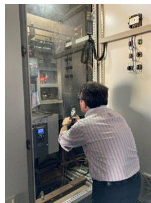
IoT 電力センサユニットの受信状況モニタリング
