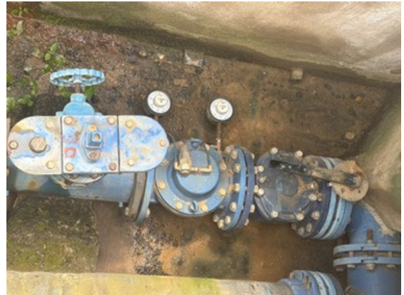
写真: SIRC 圧力センサを設置し管理ができ ている PRV
