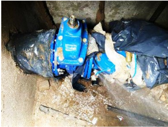
写真:不適切な管理により漏水が発生している PRV
