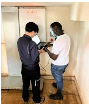
IoT 電力センサユニットの受信確認調査
