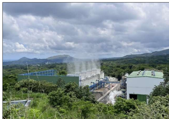
Las Pailas II Geothermal Power Plant
