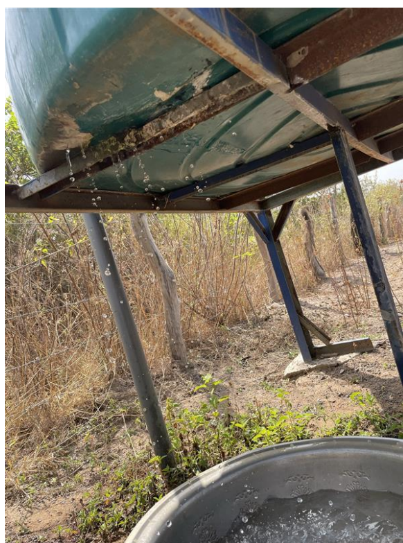
Figure 8.1.5 Réservoir d'eau vétuste
