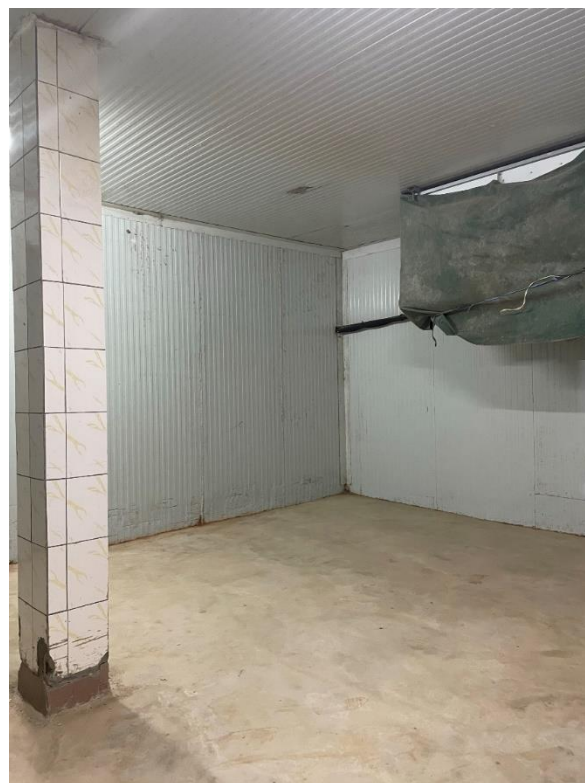
Figure 8.3.5 Équipement frigorifique de station de conditionnement
