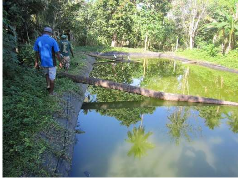
図24 被害を受けたコミュニティ池
