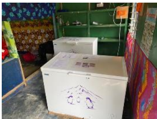
ソーラー冷凍庫設置状況
