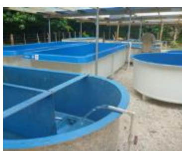
新たに設置した供与機材のFRPタンク
