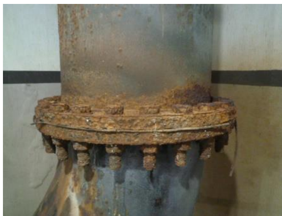
上記写真の詳細 ボルトの錆・パッキンのへたり
