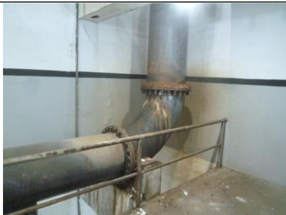
ヘッダー管からの立ち上がり部分
