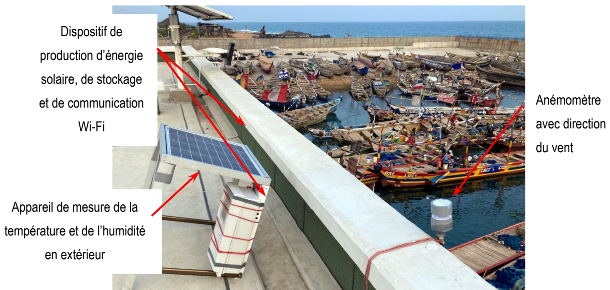
Photo 1-2 Production d'énergie solaire + unité de stockage et anémomètre, capteur de température et d'humidité extérieure
