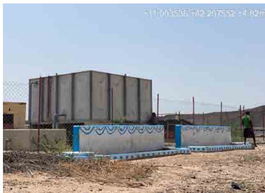
Approvisionnement en eau par puits profond (Sabbalou JICA Grant Aid)
