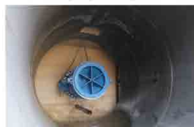
Tuyau de sortie inférieur pour abaisser le niveau d'eau du réservoir (Max. environ 12 m 3 /s)
