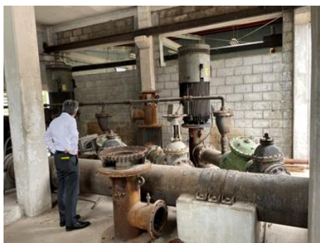
Canteras ポンプ場
