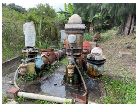
Estiquirin ポンプ場
