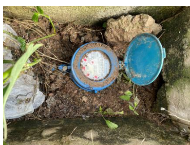
出所:調査団撮影(2024 年 11 月) 稼働中のメータ
