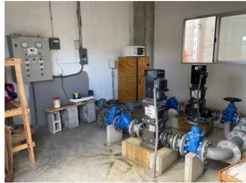
サンフランシスコ配水池 揚水ポンプ
