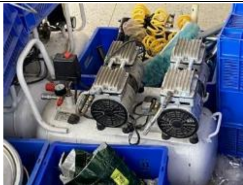
コンプレッサー
