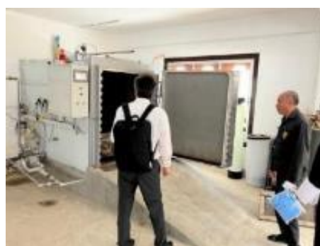
NMC・高圧蒸気圧力殺菌釜
