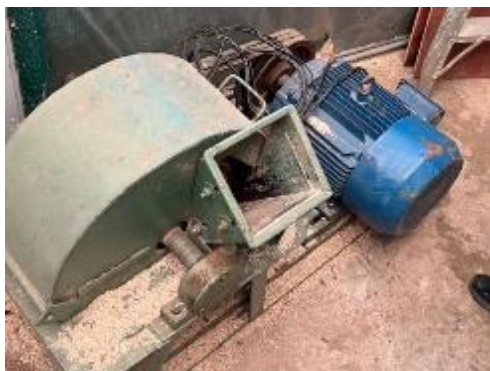
簡易木材チップ製造機 (故障中)
