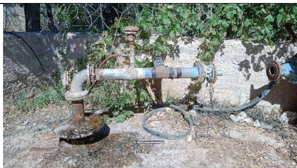
[写真-3] Mreigha 井戸および接続配管
