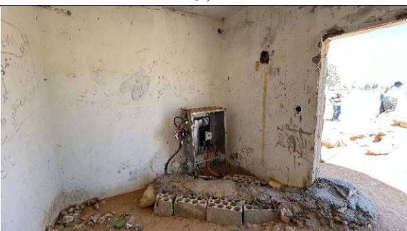
[写真-7] Tahouna 4 井戸の電気室
