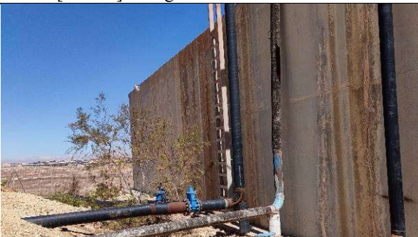
[写真-5] New Tahounch 配水池の流入管（流量計なし）
