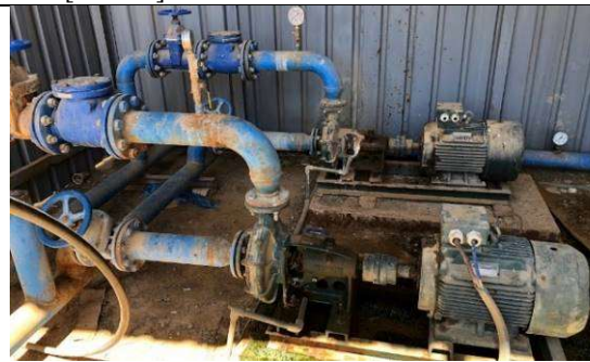
[写真-6] Sath Ma'an 配水ポンプ場の老朽化ポンプ
