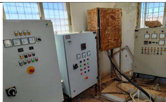
[写真-8] Manshiyeh 配水ポンプ場の電気室
