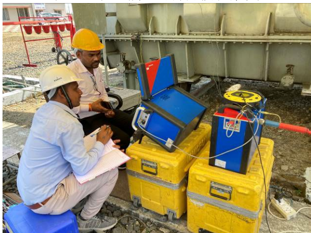
変圧器の定期点検の様子 (ダール変電所：外部評価者撮影)
