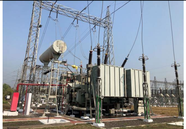
本事業で建設されたジャバルプール変電所（外部評価者撮影）
