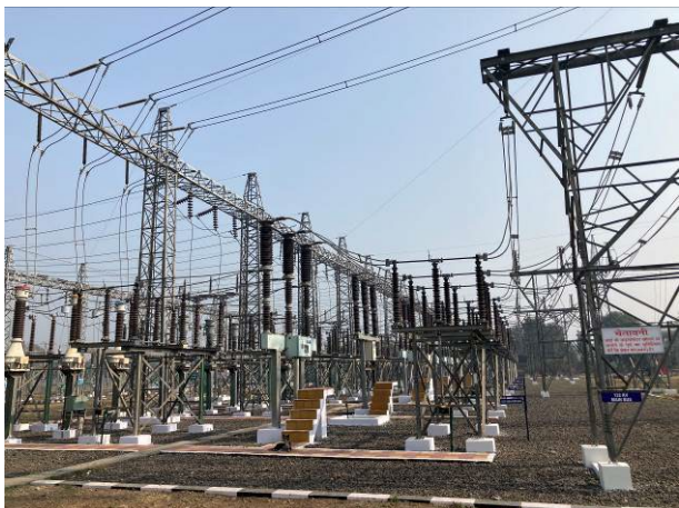
変電所の開閉器 (ジャバルプール変電所：外部評価者撮影)
