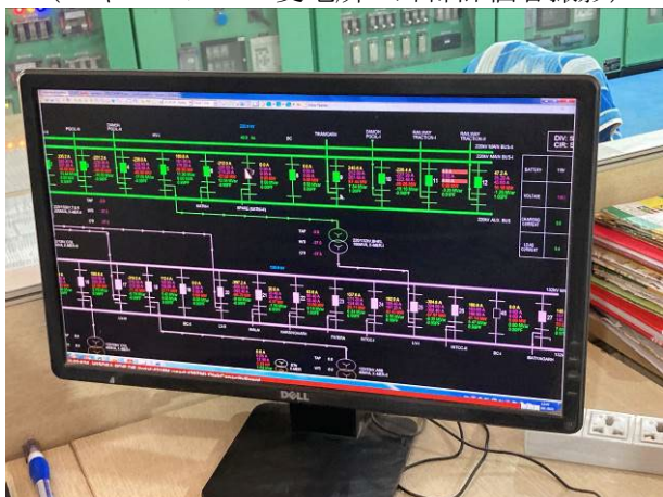
変電所の SCADA ディスプレイ (ダモール変電所：外部評価者撮影)
