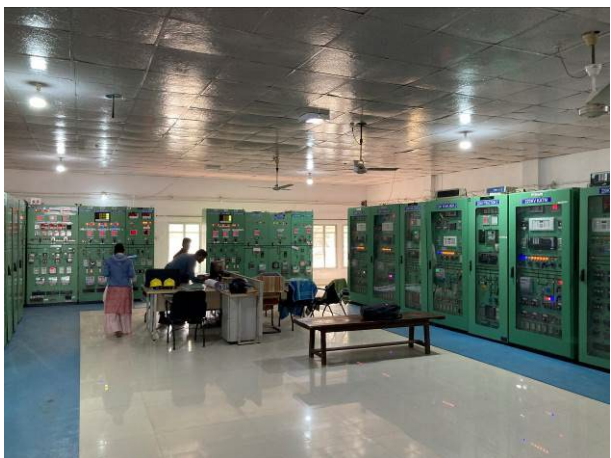
変電所のコントロール・ルーム (ダモール変電所：外部評価者撮影)
