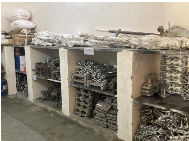
変電所のスペアパーツ在庫 (ゴラバザール変電所：外部評価者撮影)
