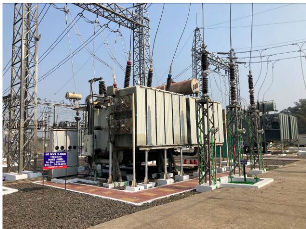
本事業の変圧器（手前）・後に増設された変圧器（後方） (ジャバルプール変電所：外部評価者撮影)
