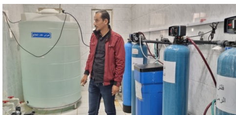
透析室、滅菌室、検査室用の水浄化施設 写真：評価者撮影
