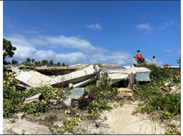
2022年1月に発生したトンガ HTHH 津波で被害を受けたトンガタブ島西部のリゾート
