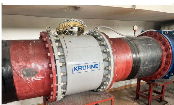
【写真 3】欧州製電磁流量計が装着された 大口径水道管
