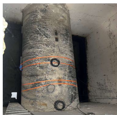
【写真 4】非接触型超音波流量計が装着 された大口径水道管
