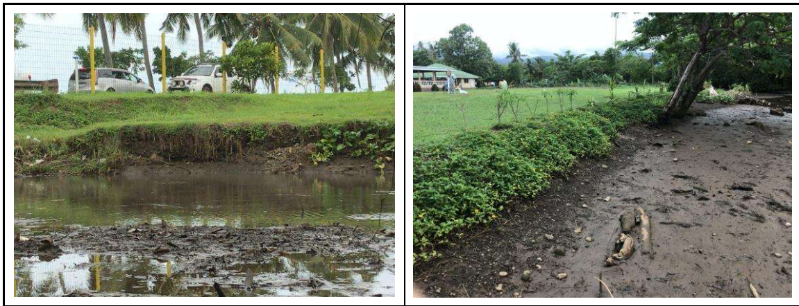
Fagalii tai outlet-5 の状況（左：右岸浸食状況、右：土砂堆積状況）
