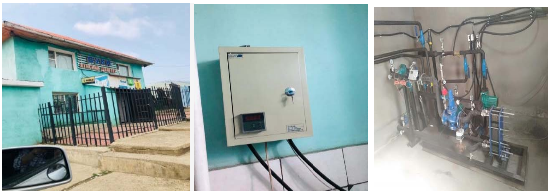
Зураг 1. Цахилгаан халаалтад холбосон байдал
