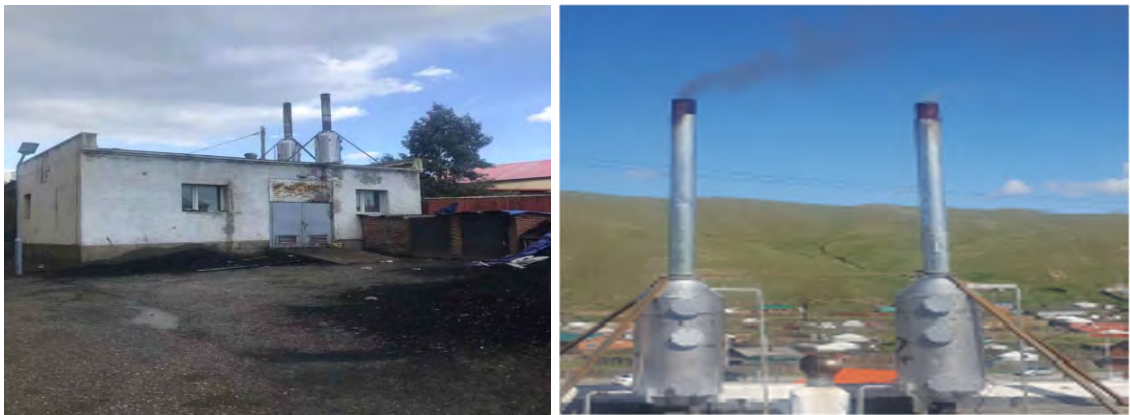
Зураг 3. Халаалтын зууханд утаа шүүгч суурилуулсан байдал
