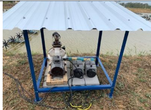
導入効果確認実験でのポンプの設置状況
