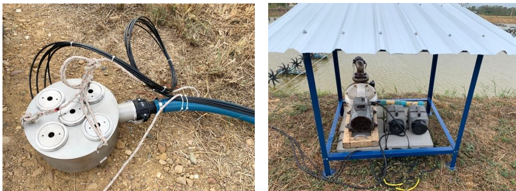
図 2-8 提案製品（ECBL-5N）の設置状況 左) マイクロバブルを発生するノズル部 右) ポンプ（消費電力 1,500W, ミニコンプレッサー） 出典：提案法人作成
