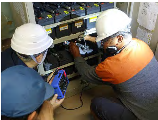
1/26 バッテリー点検状況
