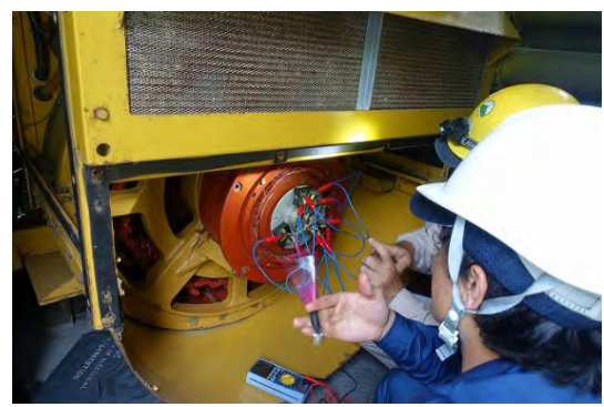
6- 発電機絶縁抵抗測定実習
