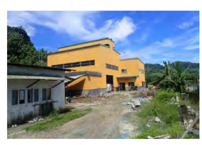
新規 DG 発電所建屋
