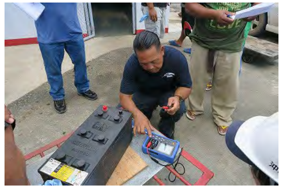
蓄電池点検（内部抵抗測定）
