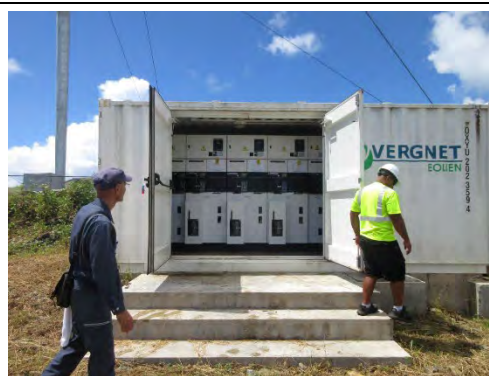
遮断器等を収納したコンテナ
