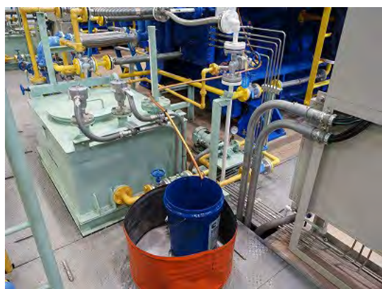
1/24 9号燃料漏れ状況
