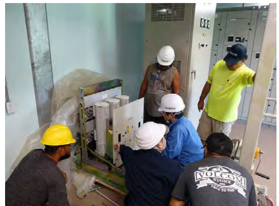
1/26 VCB 点検状況
