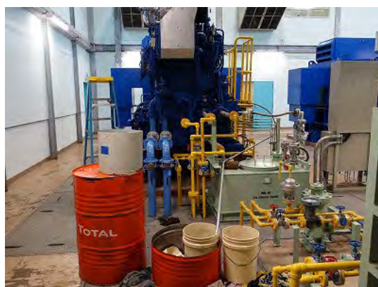
1/24 10号燃料漏れ状況
