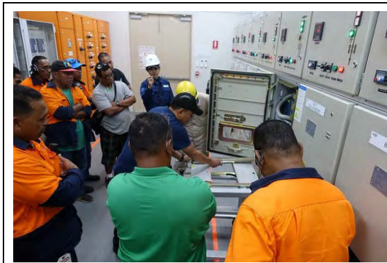
3-遮断器（VCB）点検実習
