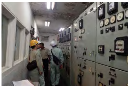
発電所制御室
