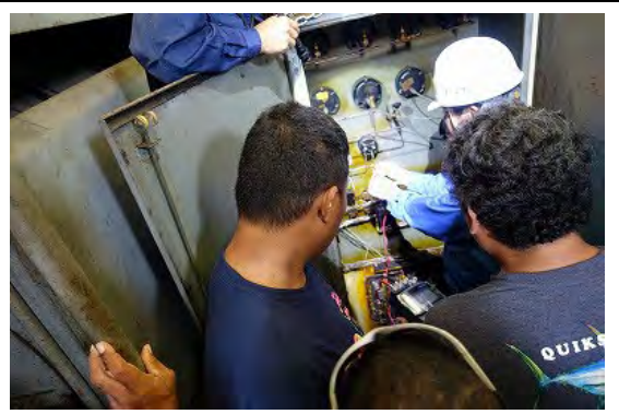
アナログメータ点検（ループテスト）
