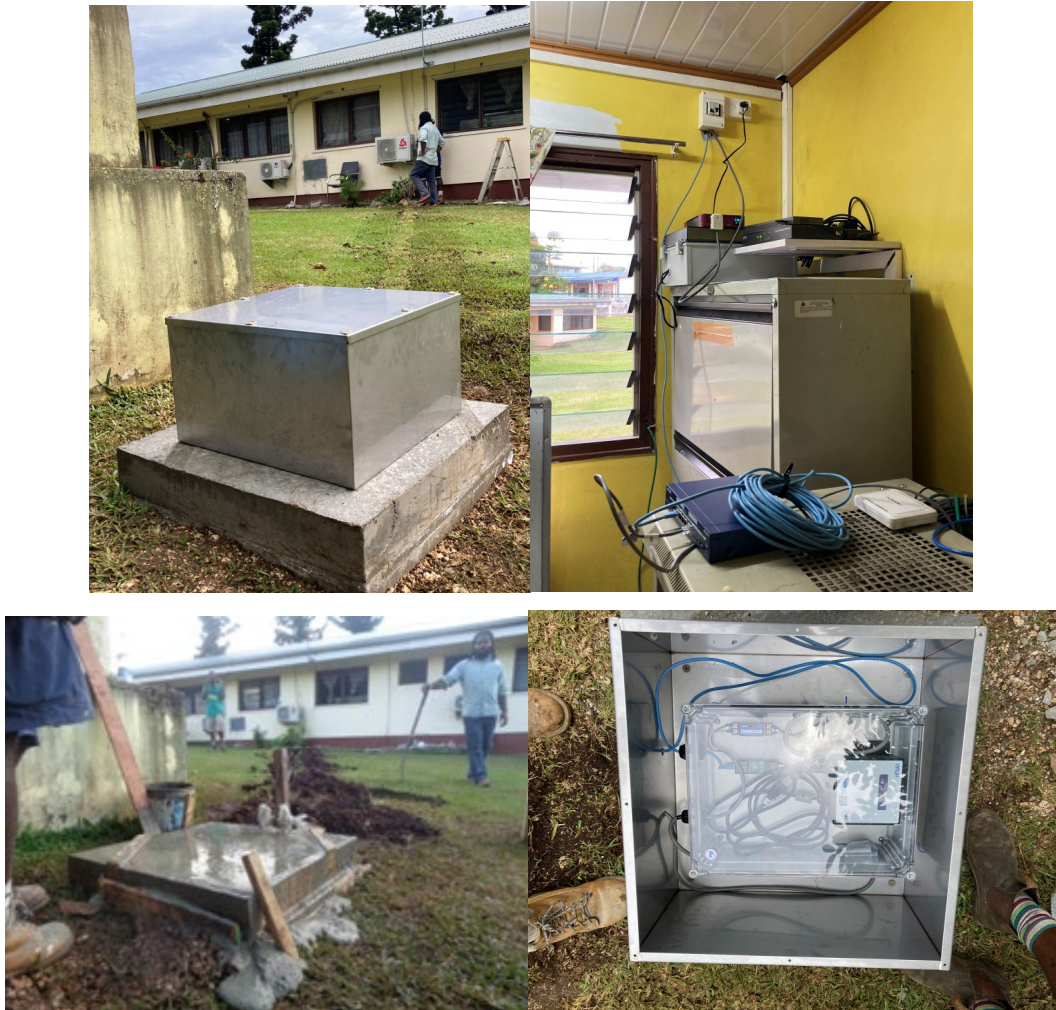
図 3.6.18. 震度計設置（シェファプロビンスオフィス）
