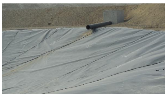
浸出水の排出形跡
