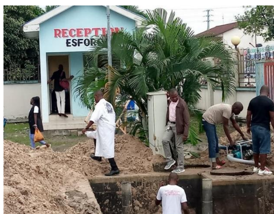
Activité de KAIZEN sur l'environnement pour la formation menée au sein de la DP Kinshasa (amélioration des problèmes d'évacuation des eaux des toilettes)
