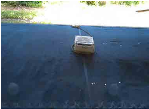
Rocket プロジェクトの対象農家に配給されていた温度センサー。壊れており現在は使われていなかった。
