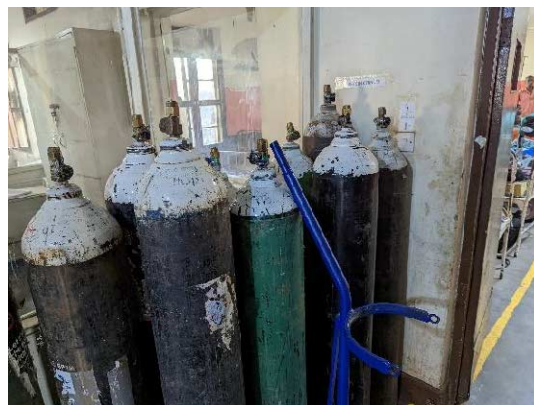
酸素ボンベ (小児科) 酸素プラントからの酸素充填に時間がかかり問題を抱えている。
