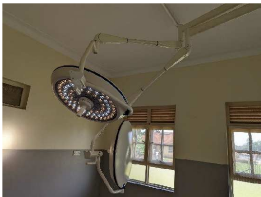
手術灯 (産婦人科手術棟) ドナー支援により手術灯が設置されたが、麻酔器がなく稼働していない。
