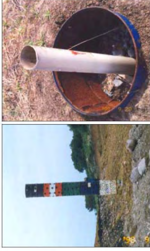
Ejemplo de una instalación sencilla para ventilación de gases
